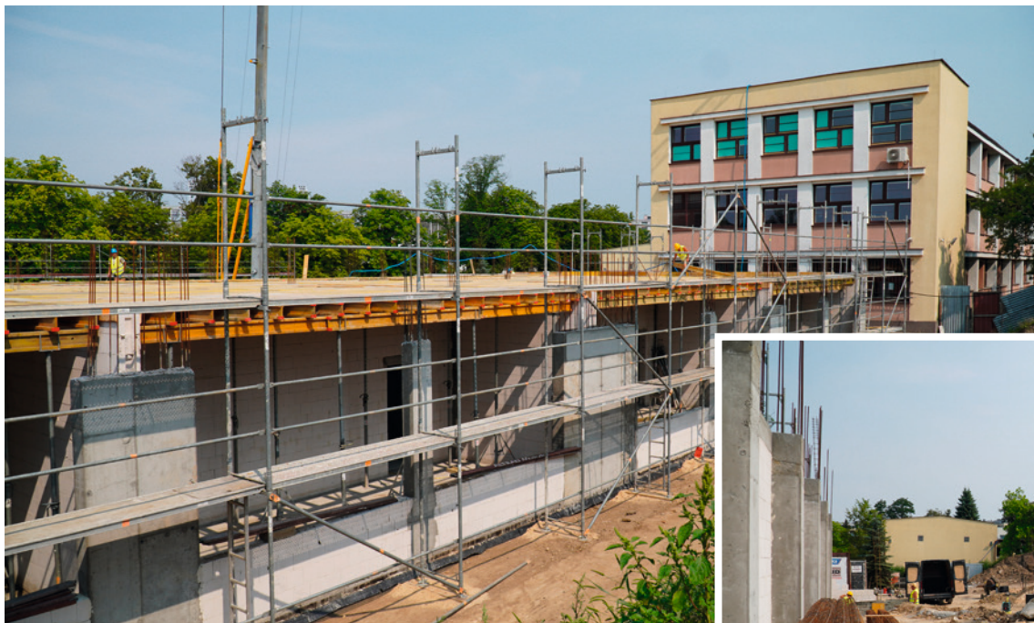
● Przy Żeromskim za ponad 13 milionów złotych powstaje nowoczesna hala sportowa z salami dydaktycznymi. Inwestycja ma być gotowa w sierpniu 2023 roku.
