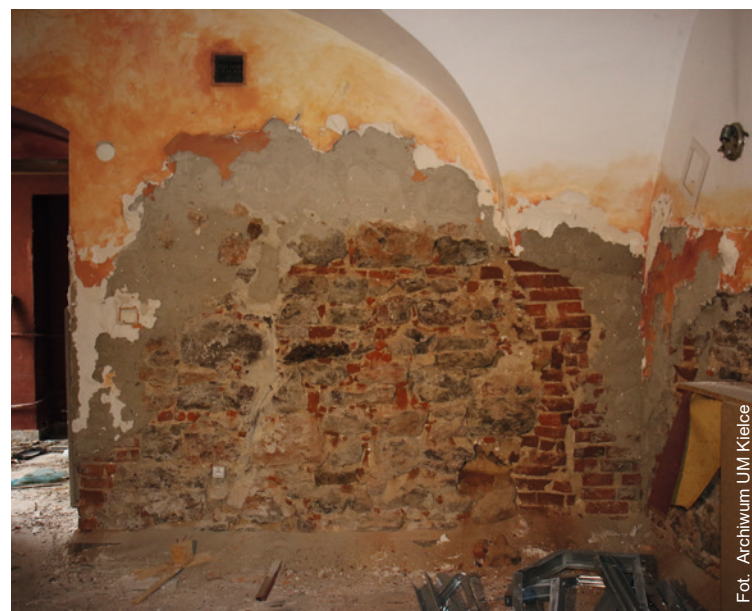
● Gmach na Wzgórzu Zamkowym wymaga kapitalnego remontu.
